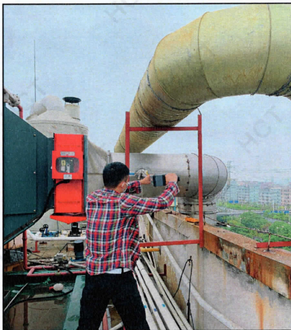
工业废气处理前检测口
